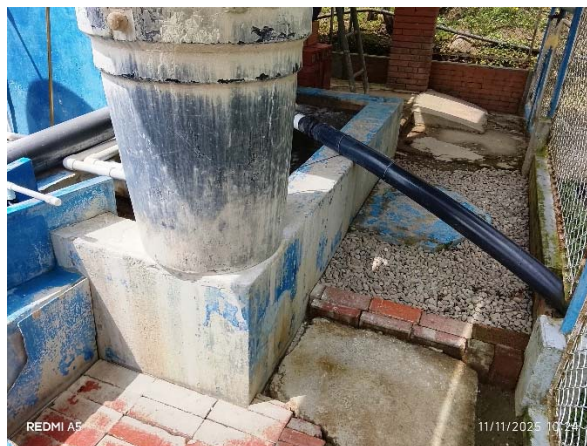
Imagen 4. Tanque de mezcla rápida y aforador Parshall
